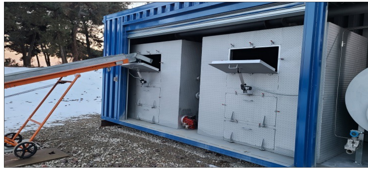
熱分解炉の投入口の開閉無線作動OPEN/CLOSE
